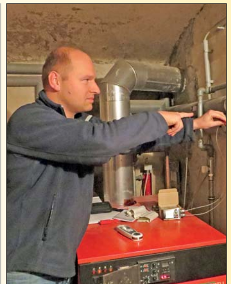
Energie-Manager Michael Hegenbart prüft mit einem Messgerät an der Erdgas-Heizanlage in der Verwaltung Röhrsdorf die Wärme, welche in den Kreislauf der Anlage gelangt.
